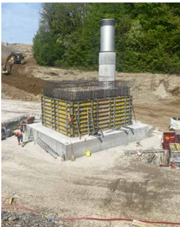
Abb. 3.2: Ansicht der neuen Stollenlüftung: Ansaugkamin Ost; neue Einführung der Stollenluft ins SWALBA-Gebäude
